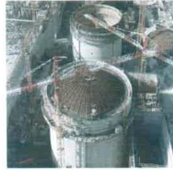
Enceinte de confinement de la centrale nucléaire du Tricastin, France, mise en service en 1980
