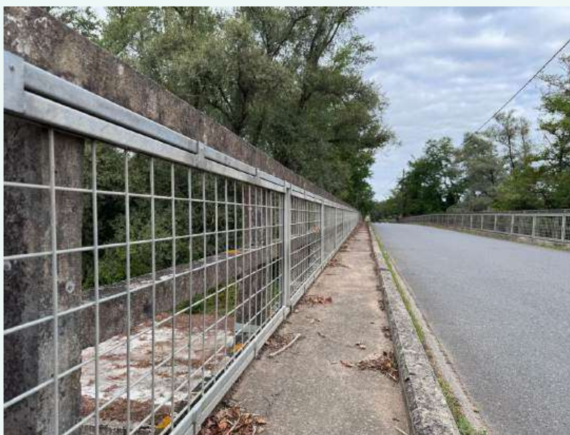
Garde-corps d'origine renforcé par un treillis métallique
