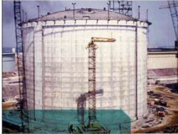
1983 RÉSERVOIRS DE GAZ PÉTROLIER DE DAS ISLAND A ABOU DHABI Freysinet réalise les travaux de préfabrication et de montage des réservoirs GPR de 80'000m 3 chacun et quatre réservoirs GPL d'une capacité totale de 10'000m 3 ÉMIRATS ARABES UNIS
